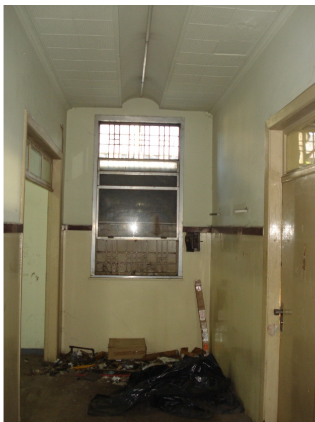
FIGURAS 6 e 7 - Exemplos de intervenção pouco criteriosa nas esquadrias originais. Ed. Arthur Guimarães
