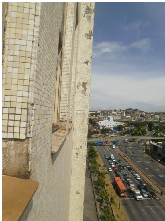
FIGURAS 10 e 11 - Vista do coroamento da caixa-d'água e detalhe do desprendimento em larga escala do revestimento da fachada. Ed. Arthur Guimarães
